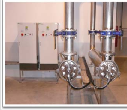
UV-Anlagen zur Prozesswasserdesinfektion 2 x UXP P 3200 (2 x 168 m 3 /h) Deutschland
