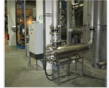
UV-Anlage zur Prozesswasserdesinfektion UXP P 4400 (340 m 3 /h - 40°C) Deutschland
